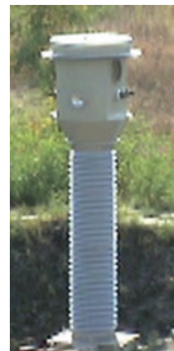
Рис. 6. Испытываемый трансформатор ТФРМ-330Б-У1
