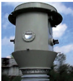
Рис. 2. Верхняя часть трансформатора с разгрузочными мембранами
